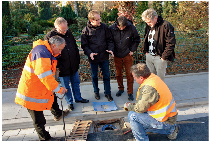
Baustellentermin (von links): Bauleiter Winfried Dörner und Teamleiter Dirk Vahrson vom Amt für Verkehr der Stadt Bielefeld, Funke-Fachberater Ralf Erpenbeck, Koordinator Bielefeld Ost der Stadt Bielefeld, Bernhard Pehle, Betriebsleiter Kanalbetrieb Henning Freitag und Bauleiter Ullrich Mertin von der bauausführenden Karl Pollmann GmbH Bauunternehmung.
